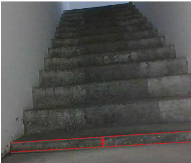
Abbildung 5.9.: Treppe mit gefährlichem, niedrigem, letzten Tritt unten
